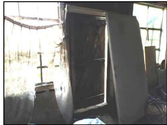
Afbeelding 11: Toegang tot schuur, openstaande deur en kapot raam
